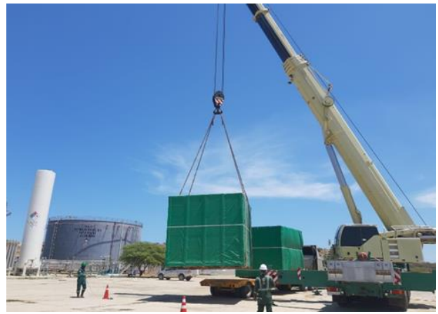
Llegada de Equipos del proyecto EV burner
